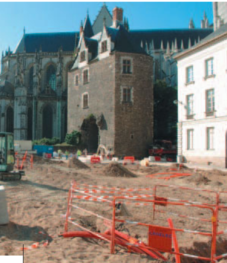
Le terminus du busway est en cours d'implantation sur l'ancien petit parking situé à l'angle de la rue de l'Évêché.
